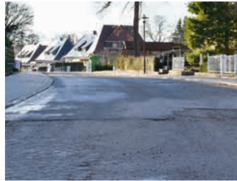
An dieser Schnittstelle in der Mozartstraße soll es nach dem Kanal- und Leitungsbau mit dem Straßenbau weitergehen. Die jetzige Straßenoberfläche ist provisorisch.
